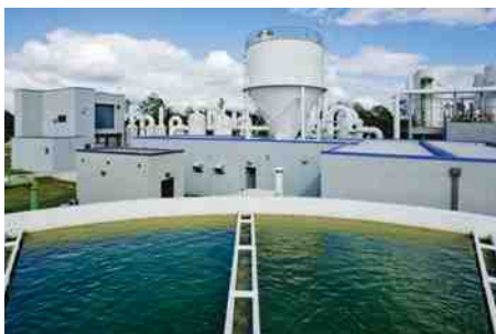
Agua potable y aguas residuales
