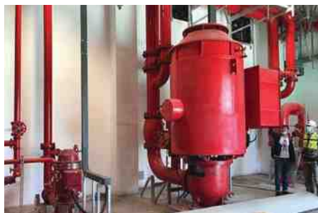
Protección contra incendios
